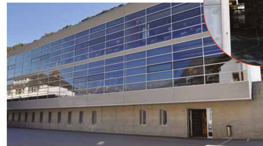
Une des nombreuses parois vitrées vandalisées du Cycle d'Orientation de Grône.
